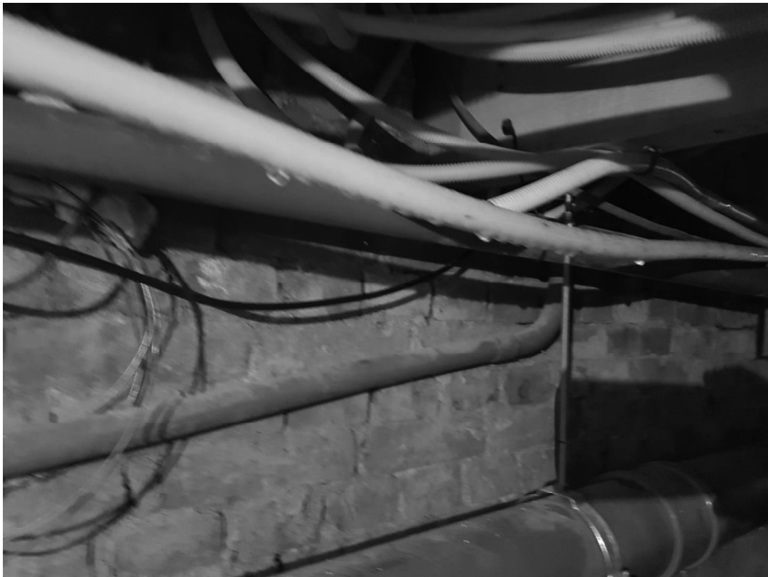
Condensvorming aan de onderzijde van het leidingwerk.
