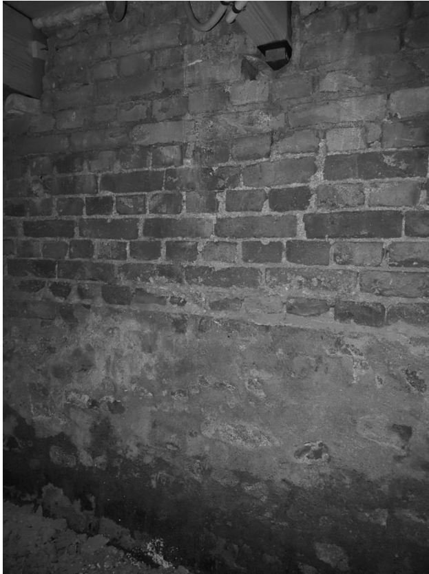
Onderzijde van de fundatie te vochtig, zie donkere plekken.
