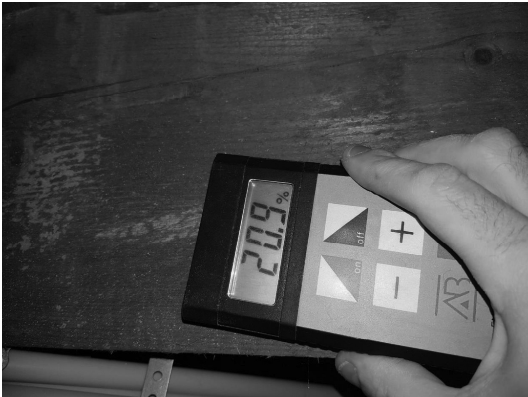
Vochtwaarde van het houtwerk is te hoog, maximaal 20% toelaatbaar.
