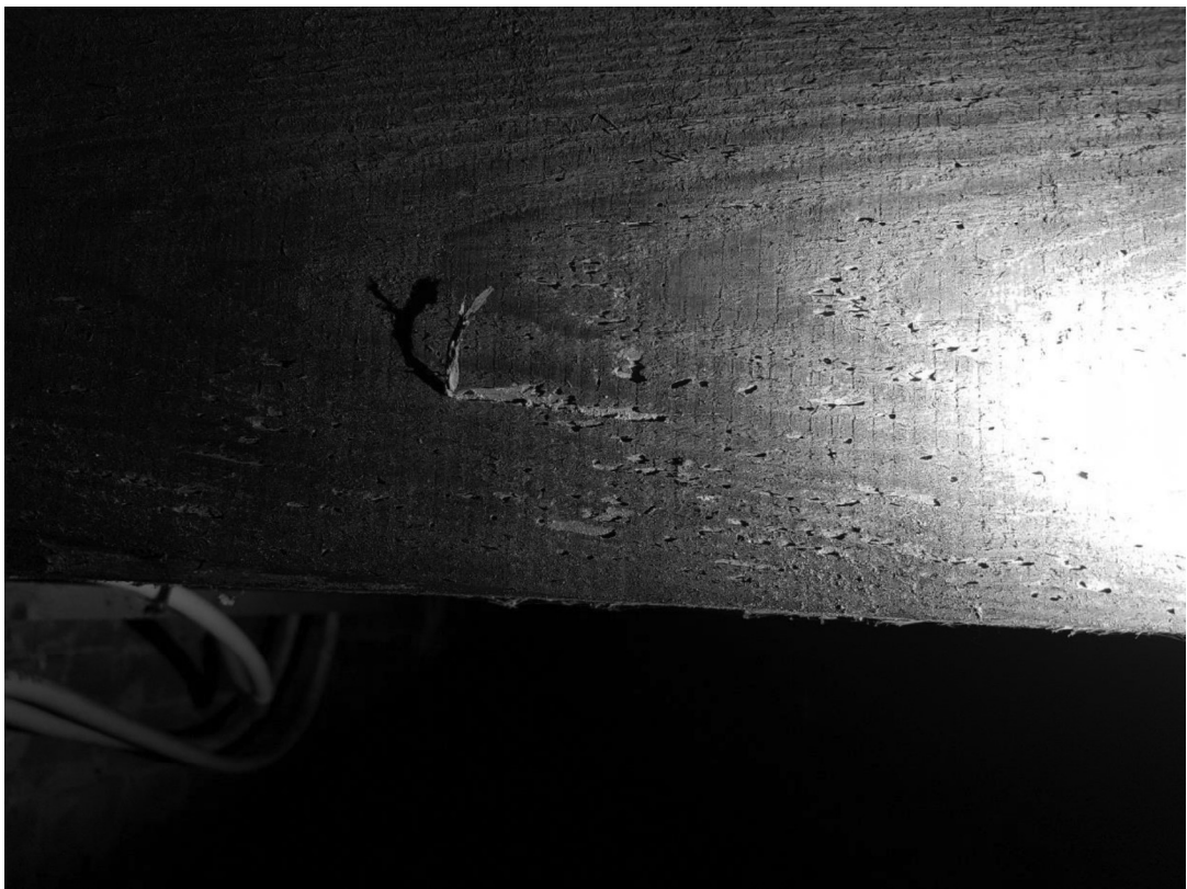
Houtworm in de balklaag aanwezig.
