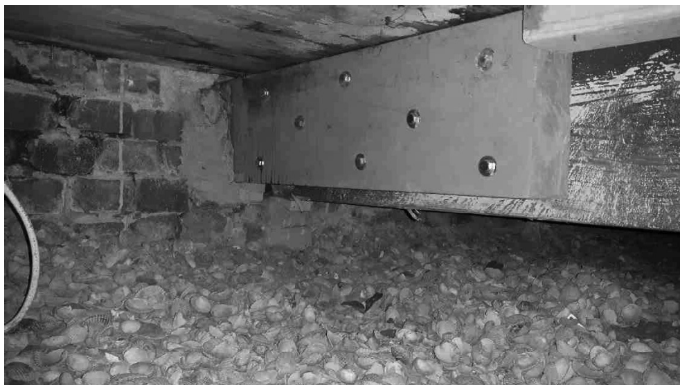
Foto 10: tweede balk idem als strijkbalk. Beide balken zijn aangetast door kelderzwam/bruinrot.
