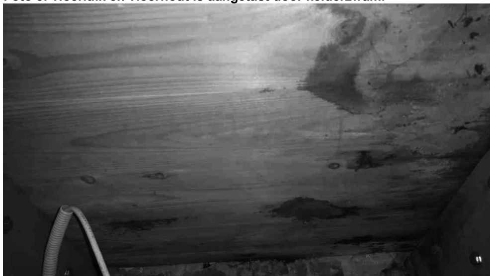
Foto 6: onderzijde vloerhout plaatselijk aangetast door kelderzwam.
