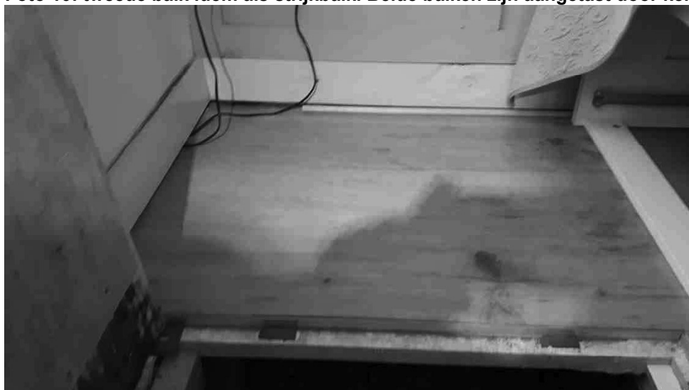
Foto 11: vloerafwerking (parket) wijkt t.o.v. de onderzijde van de plinten.
